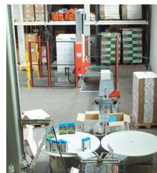
Visuale di una linea di pallettizzazione semiautomatica alimentata da due postazioni di lavoro manuali.
